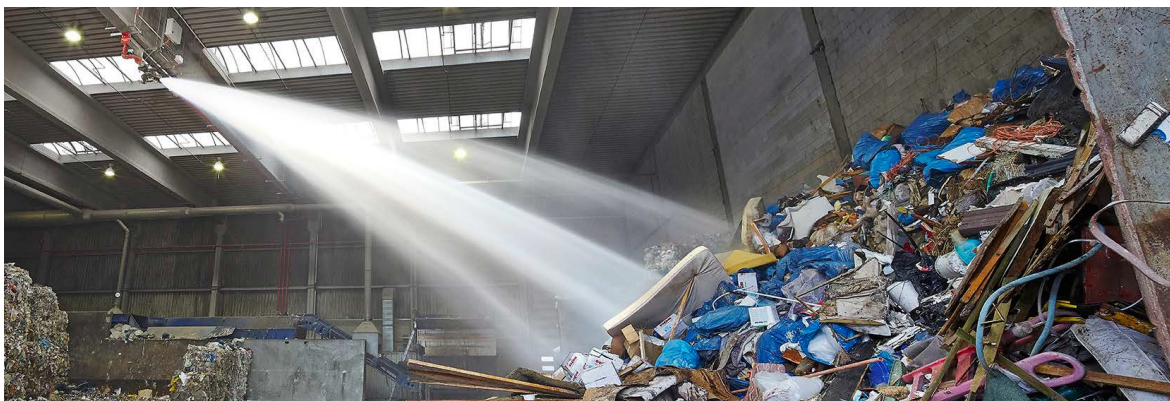
Abb. 2: Beispiel einer Werferlöschanlage der Firma Rosenbauer, Einsatz im Sperrmüll
