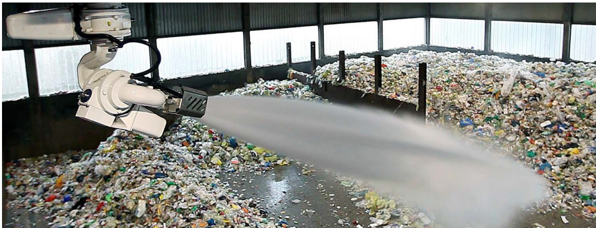
Abb. 1: Beispiel einer Werferlöschanlage der Firma Rosenbauer, Einsatz im LVP
