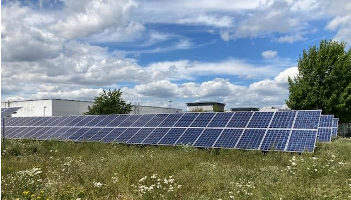
Abbildung 25: Freiflächen-PV-Anlage an der Entsäuerungsanlage Sinzig Foto: Stadt Sinzig
