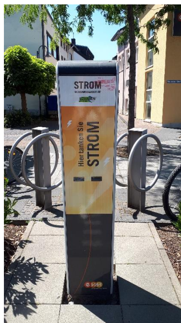
Abbildung 30: neue E-Bike-Ladestation in Remagen
