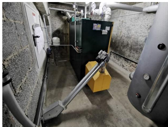
Abbildung 27: Pelletheizung der Grundschule Kempenich. Foto: Verbandsgemeinde Brohltal
