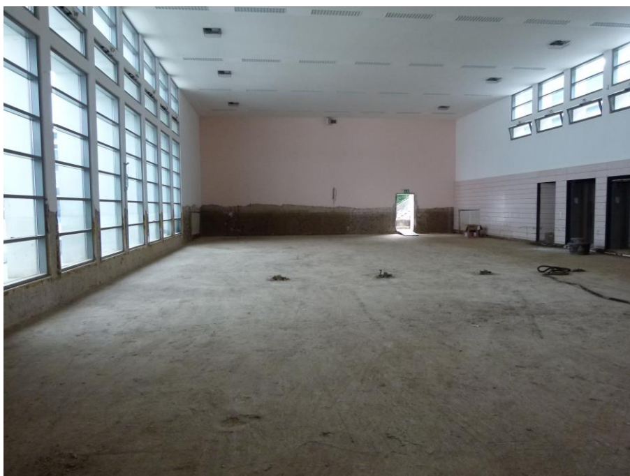
Foto 22 HS 1 - Überflutungshöhe kleine Turnhalle mit Blick Richtung Osten
