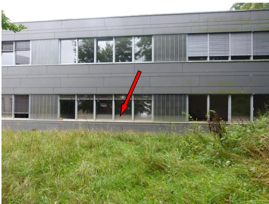
Foto 4 HS 3 - Wasserstand vor Westfassade
