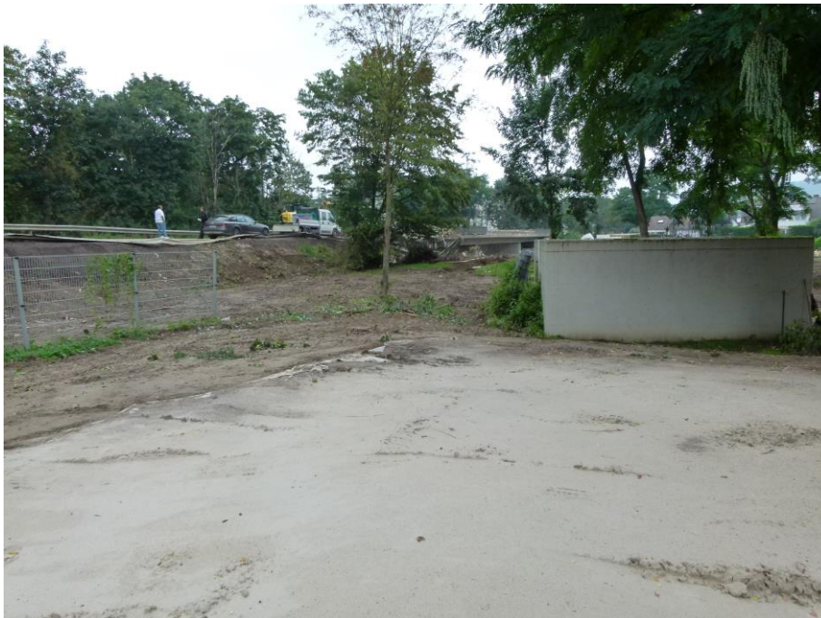
Foto 39 zerstörte bzw. nicht mehr vorhandene Einfriedung
