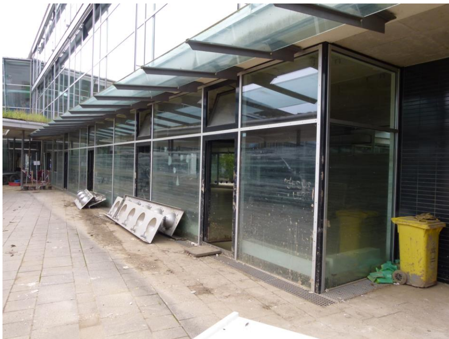
Foto 16 Nordwestfassade Westflügel Achse E/16-19
