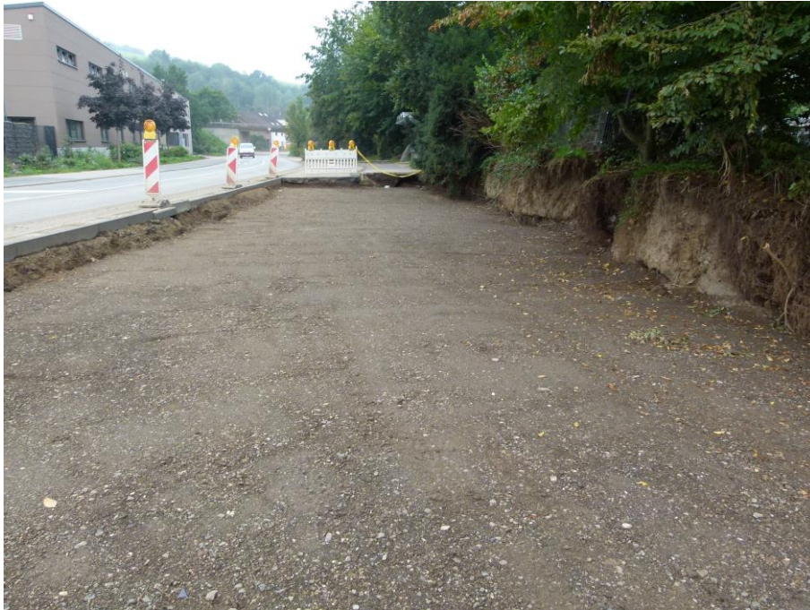
Foto 9 Zustand ehemalige Bushaltestelle
