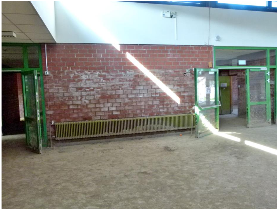
Foto 13 Ausblühungen an der Westwand der Eingangshalle
