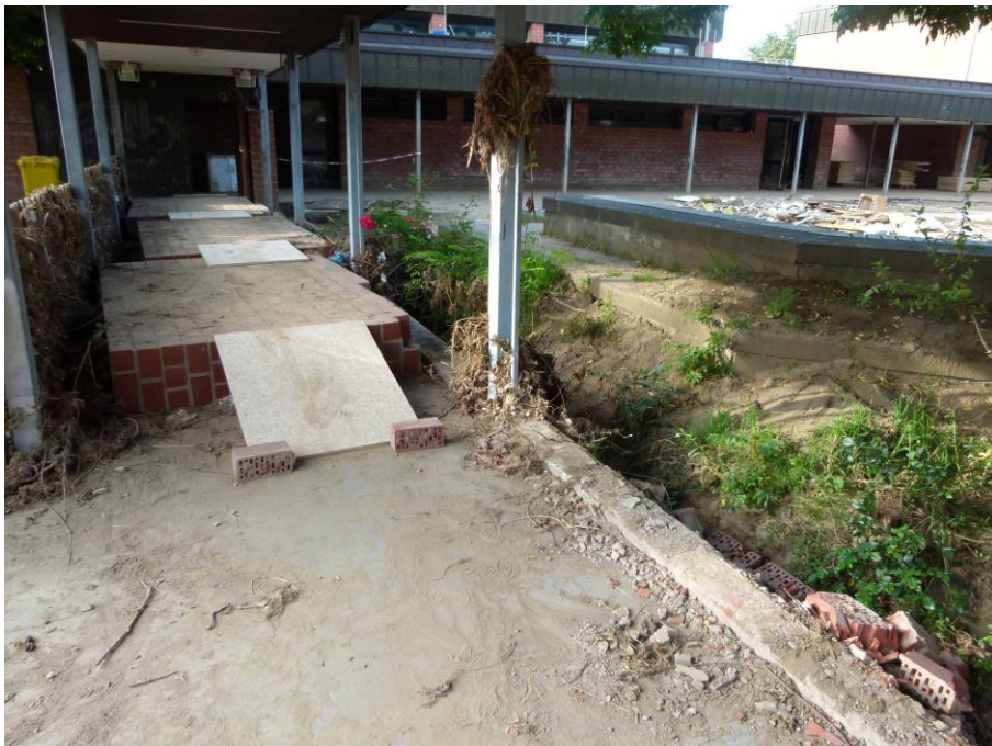
Foto 9 umgestürzte Mauerelemente Verbindungsgang
