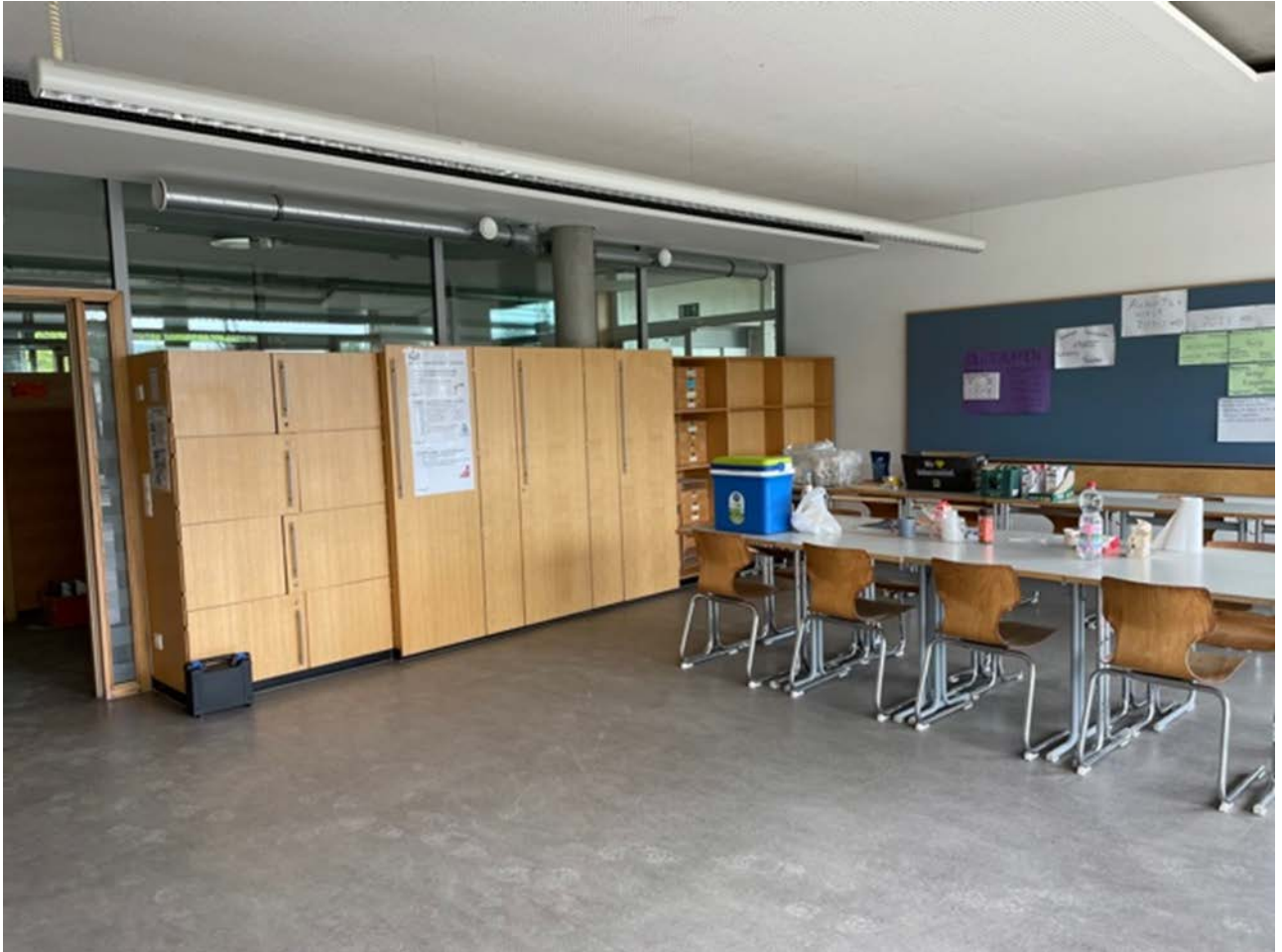
Abb.26: Klassenraum der Schule mit Abluftanlage
