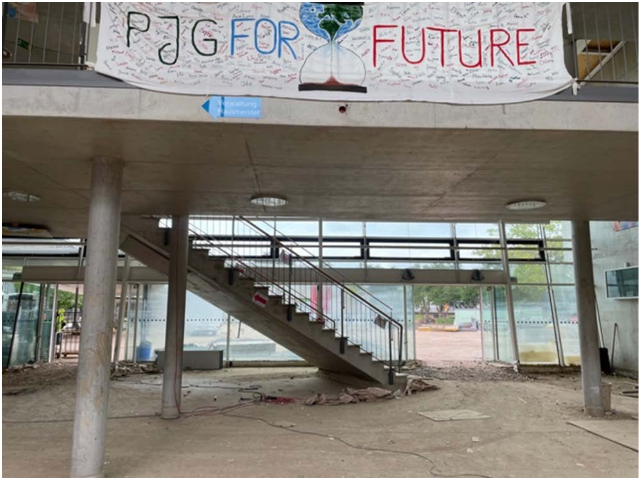
Abb. 24: Flutgeschädigter Eingangsbereich im Erdgeschoß der Schule
