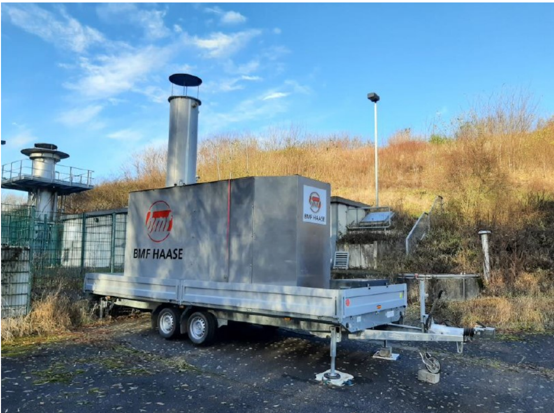
Abb. 2: Deponie Remagen-Oedingen, mobiles Mietfackelsystem für Abbsaugversuche, im Hintergrund die alte Fackel und Verdichterstation
