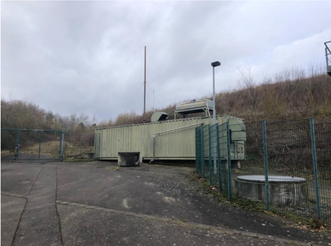
Abb. 1: Deponie Remagen-Oedingen, altes BHKW
