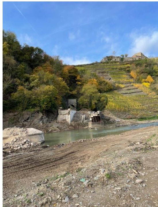
Abbildung 13: Von einer Brücke zwischen Mayschoß und Rech in der Verbandsgemeinde Altenahr sind nur die Fundamente übrig geblieben, 2021
