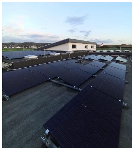
Abbildung 11: Solaranlage Sportplatzgebäude Kripp (Foto: M. Göttlicher, SV Kripp)
