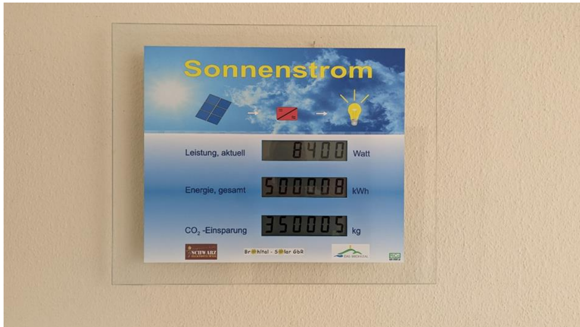
Abbildung 20: Übersichtspanel der Mitarbeiter-Photovoltaikanlage
