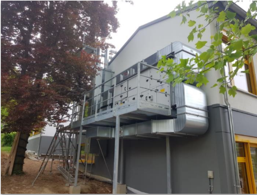
Abbildung Grundschule Pech Außenaufstellung zentrale RLT
